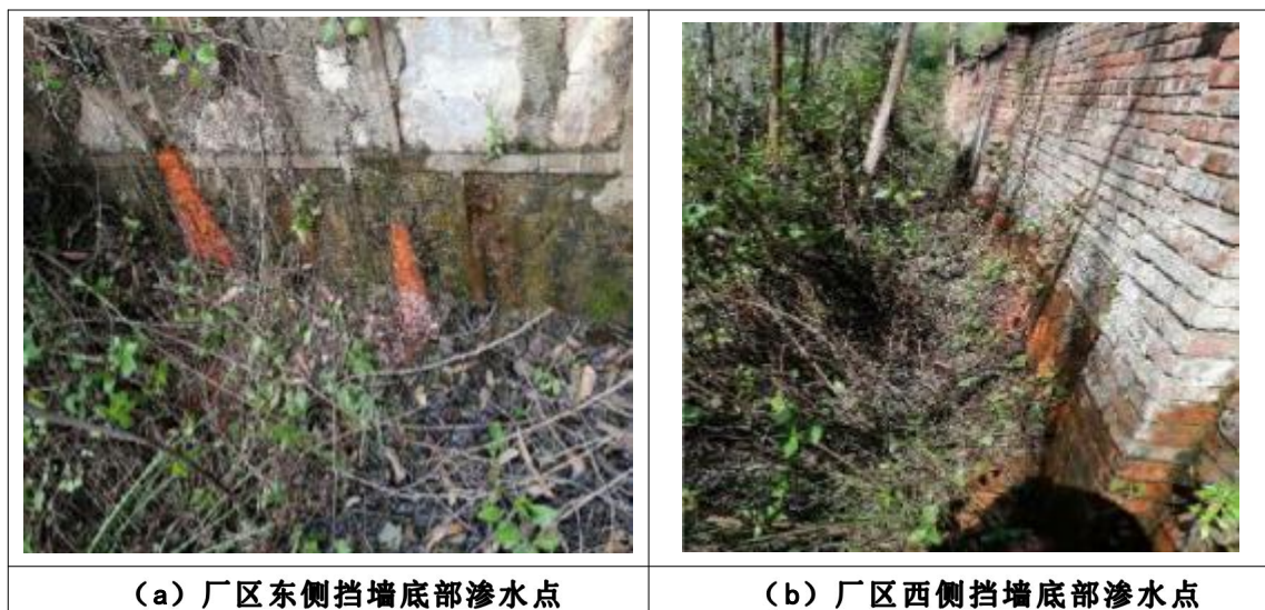
图 5.4-9 厂区挡墙底部渗水点照片
